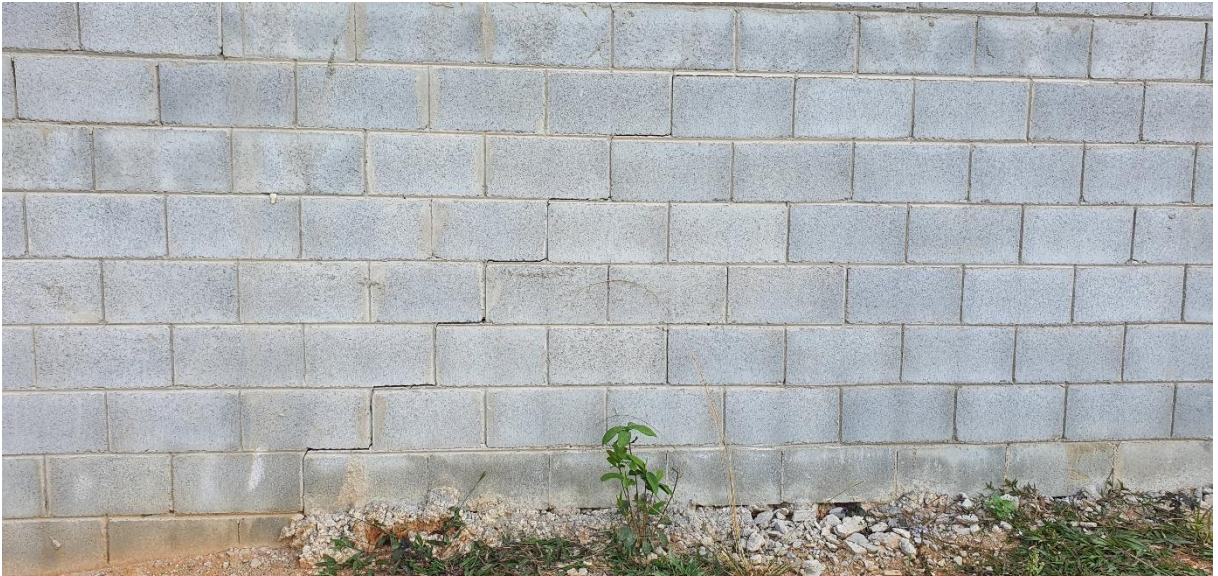
Fotos 28 – Trecho do muro que, ainda, não colapsou com apresentação de descolamento dos blocos. Imagem que demonstra, também, que a fundação não está adequadamente engastada ao solo, com pontos sobre a superfície praticamente em “balanço”.
