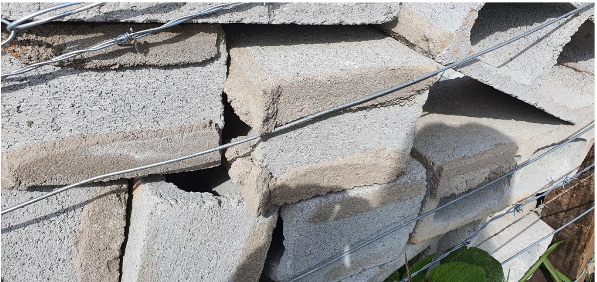
Foto 11 – Detalhe dos blocos com argamassa apenas parcialmente aplicadas.
