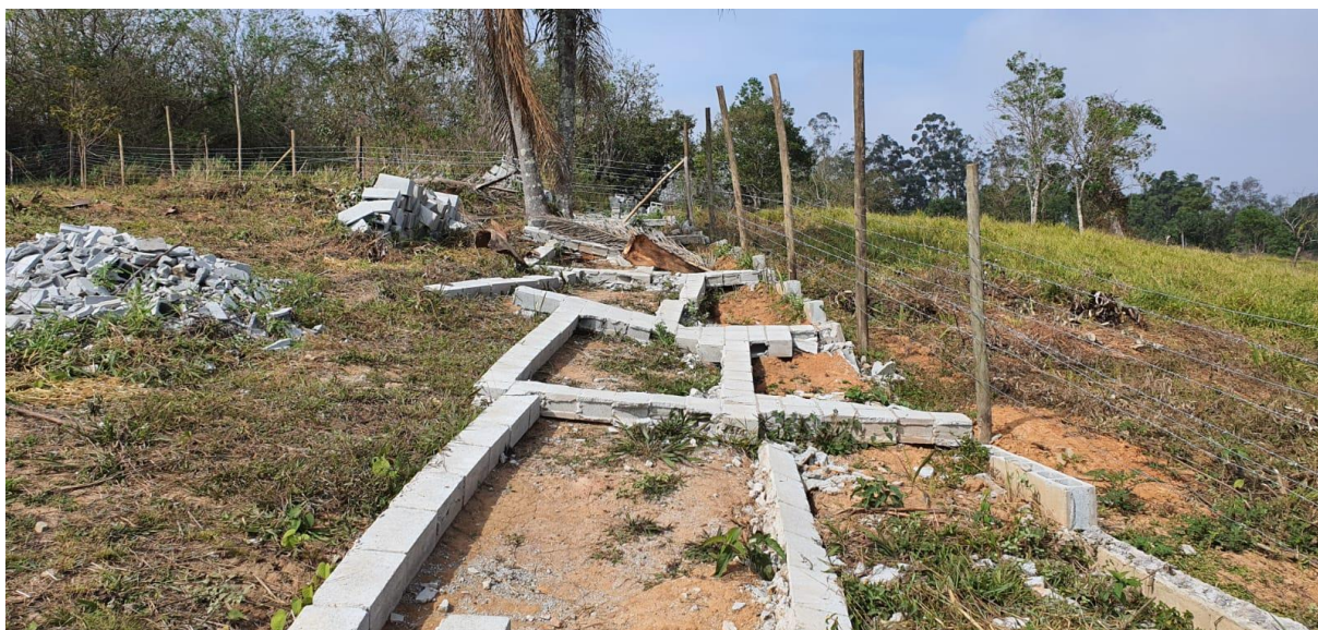
Foto 01 – Trecho colapsado demonstrando que o muro caiu uniforme e completamente, demonstrando que o ponto de ruptura do mesmo foi na base.
