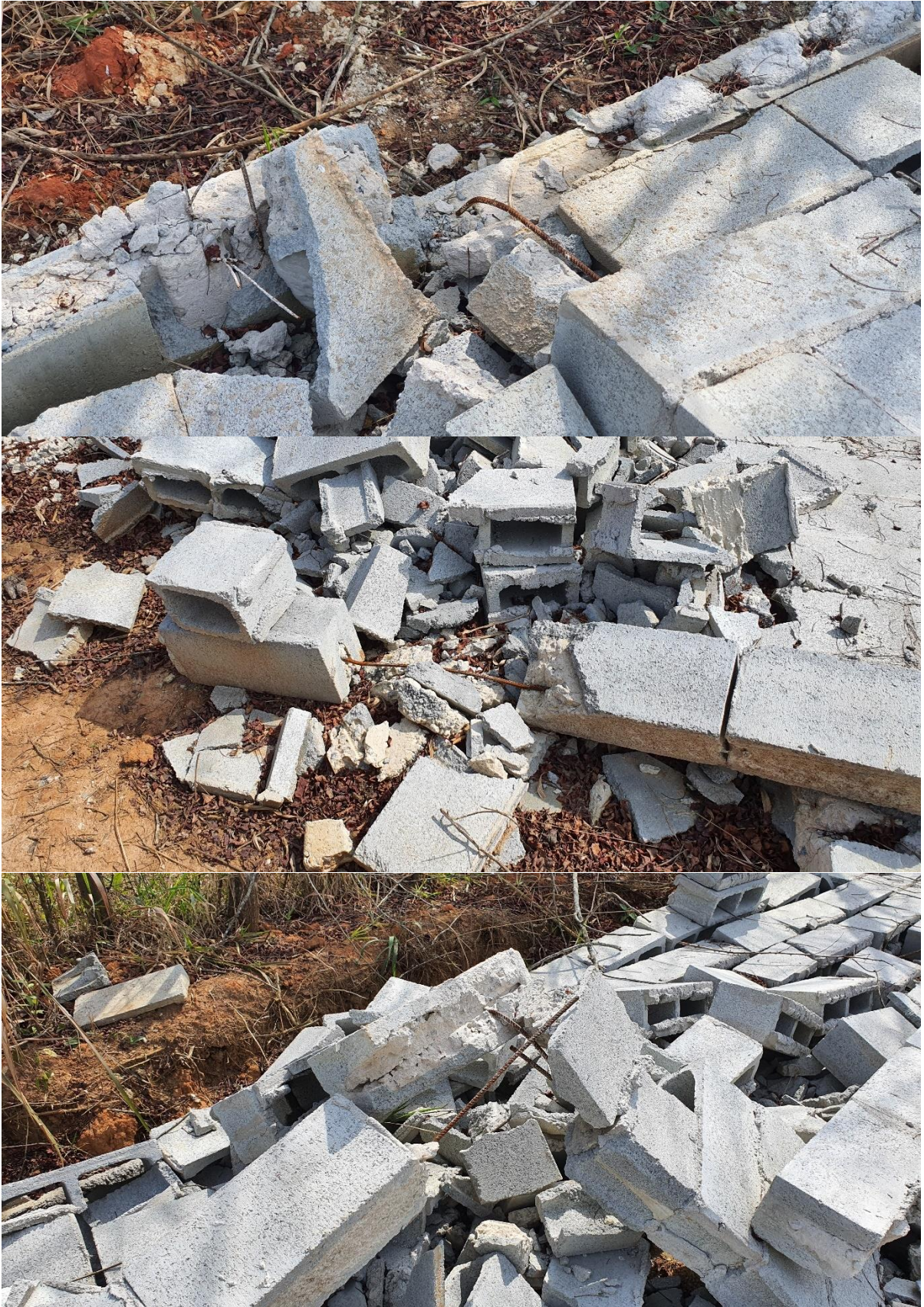
Fotos 21, 22 e 23 – Escombros de trecho do muro colapsado com demonstração da “armadura” utilizada como pilarete e cinta de amarração do muro.
