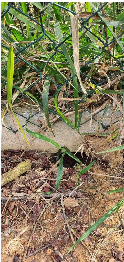
Foto 19 – Detalhes da fundação construída com blocos canaleta demonstrando que não foi construído em vala e está sobre a superfície do solo.
