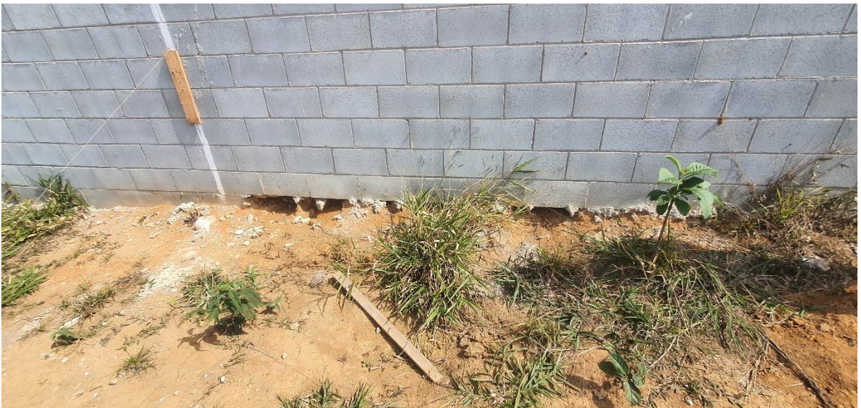
Fotos 29 – Trecho do muro que demonstra que a fundação não está adequadamente engastada ao solo, com pontos sobre a superfície do solo, praticamente em “balanço”.
