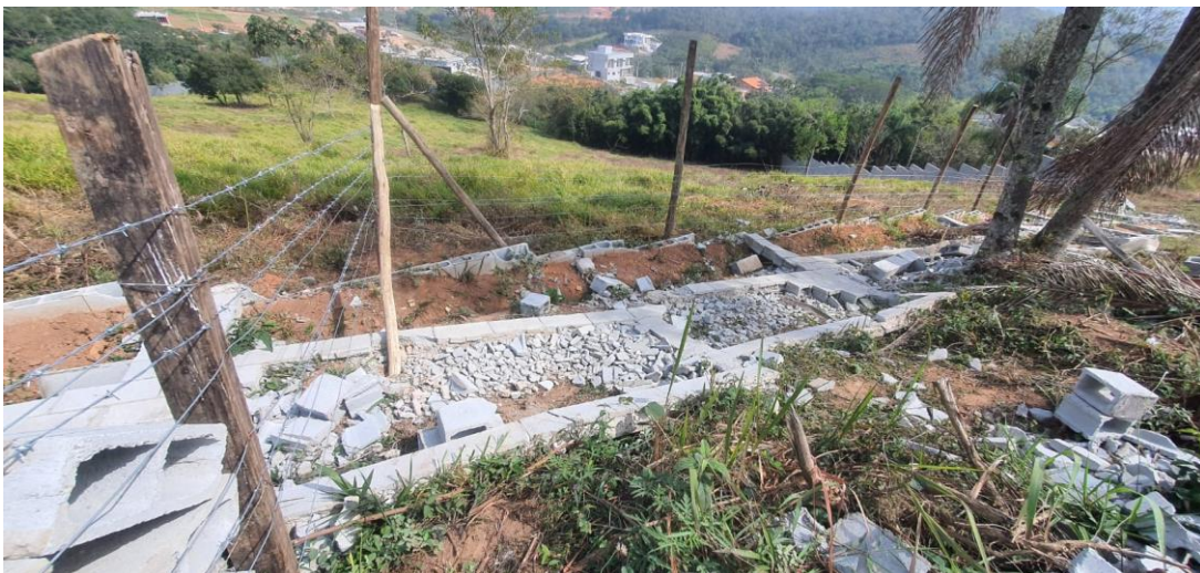
Foto 07 – Trecho colapsado, também com ruptura na base do muro, detalhe para os pontos (pilarete e cinta) que permaneceram íntegros, mas rompidos em sua base.
