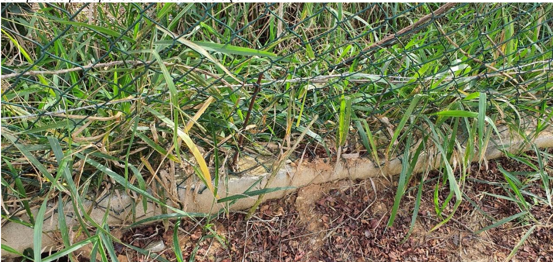
Foto 16 – Detalhe da fundação (baldrame) construída com blocos canaleta, os escombros do muro com a “armadura” do pilarete e da cinta, ambos compostos por apenas uma barra de aço.
