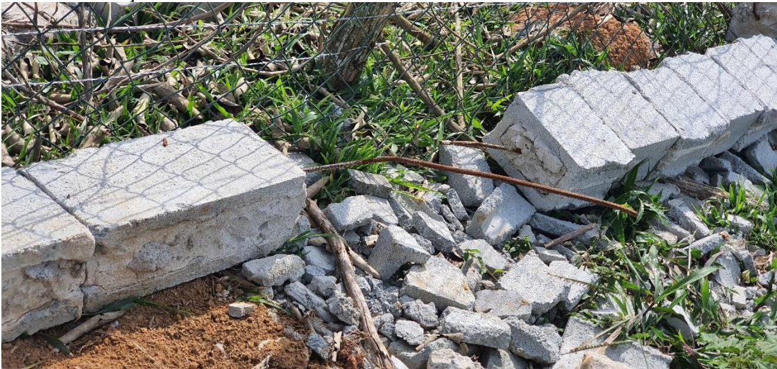
Foto 15 – Detalhe dos escombros do muro com a “armadura” do pilarete e da cinta, ambos compostos por apenas uma barra de aço.
