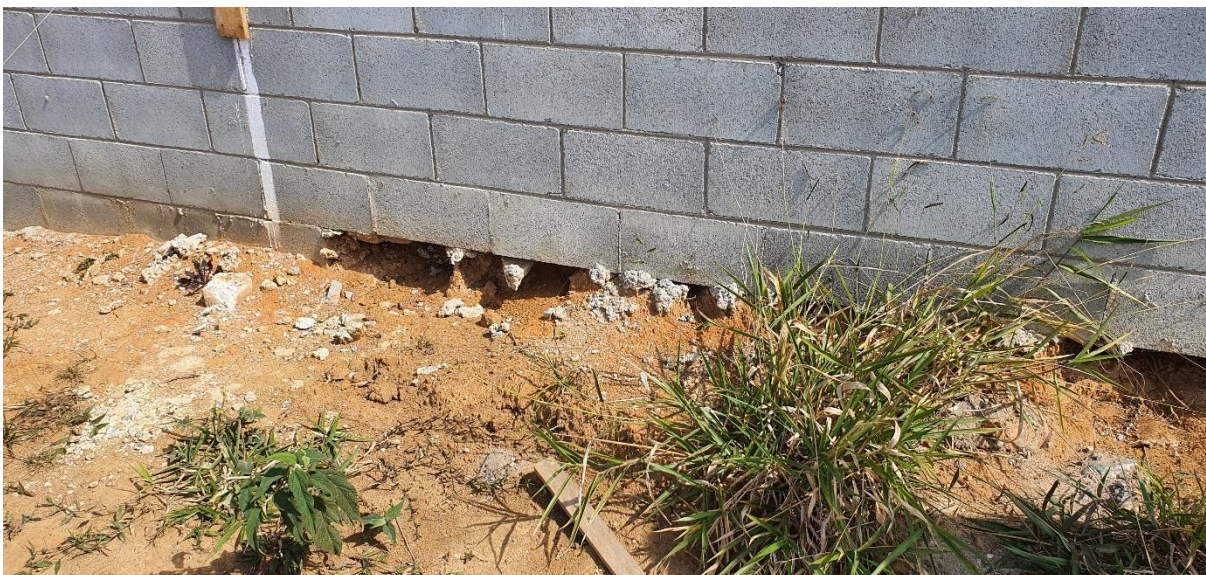
Fotos 30 e 31 – Trecho do muro que demonstra que a fundação não está adequadamente engastada ao solo, com pontos sobre a superfície praticamente em “balando”, verifica-se com clareza que o baldrame não possui a altura ou a composição informada no “detalhe típico” apresentado pela TBS.
