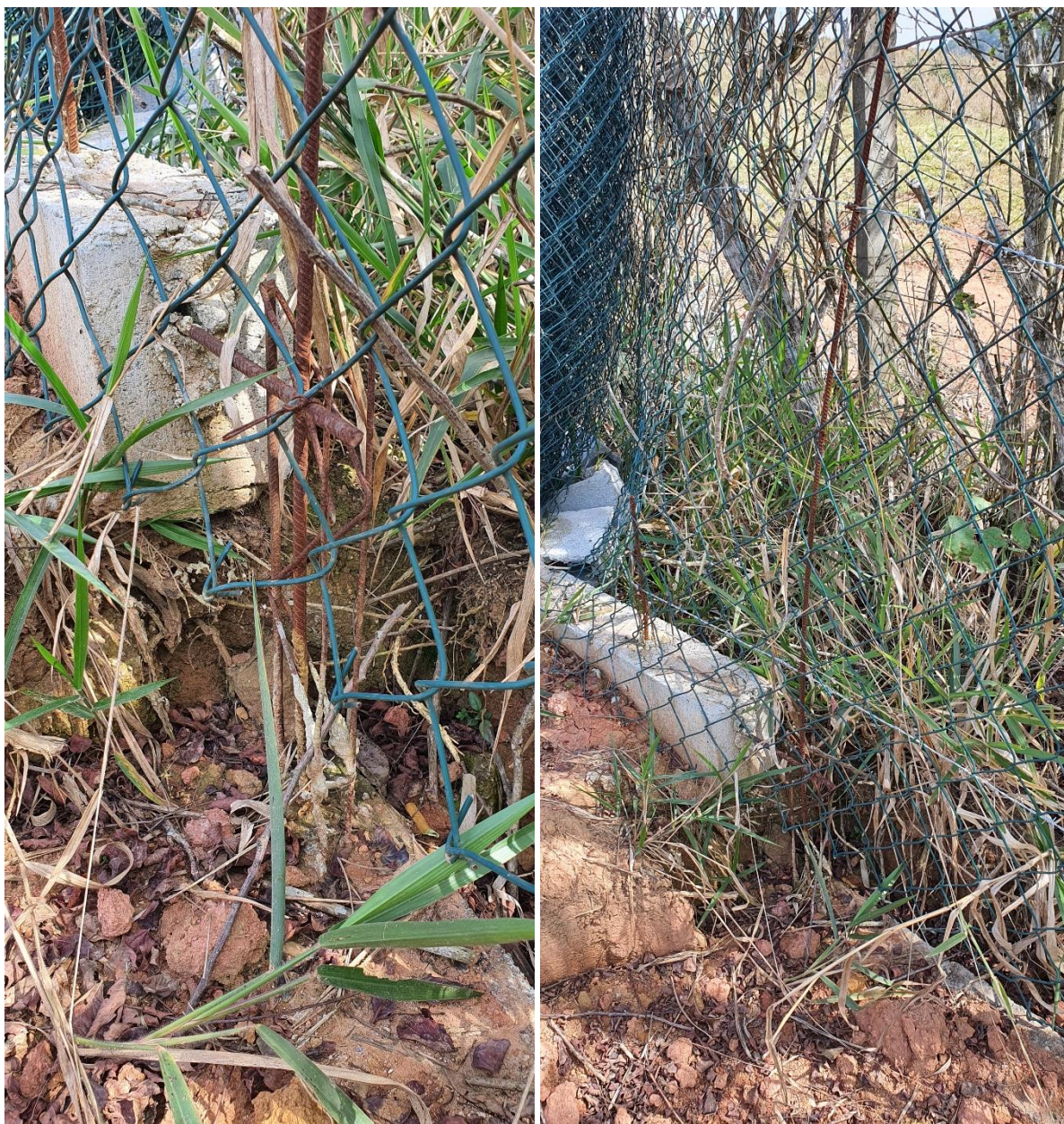
Fotos 26 e 27 – Detalhes da função do muro, com seus respectivos arranques demonstrando que a mesma não está enterrada ou “engastada” no solo, de forma a proporcionar a rigidez e o suporte necessário para o muro.
