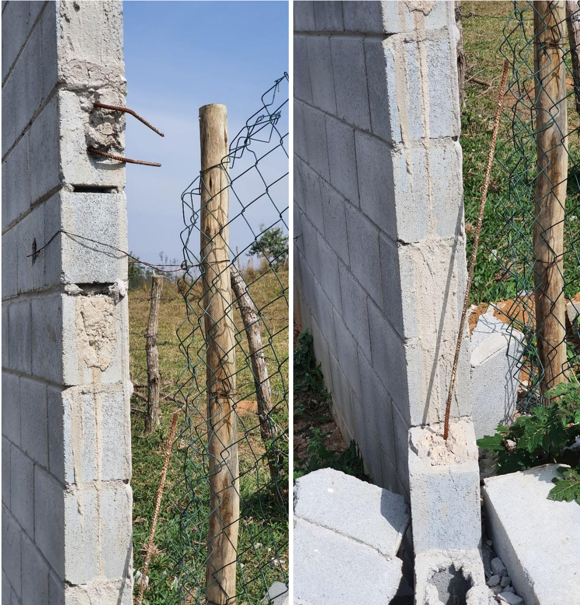
Foto 12 e 13 – Detalhe da cinta de amarração com duas barras de aço, único ponto que se verificou essa condição (foto 12 à esquerda) e do “pilarete” (foto 13 à direita) sem armação e com apenas uma barra de aço.
