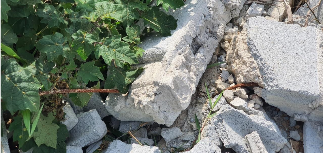
Foto 14 – Detalhe dos escombros do muro com a “armadura” do pilarete composto apenas de uma barra de aço.
