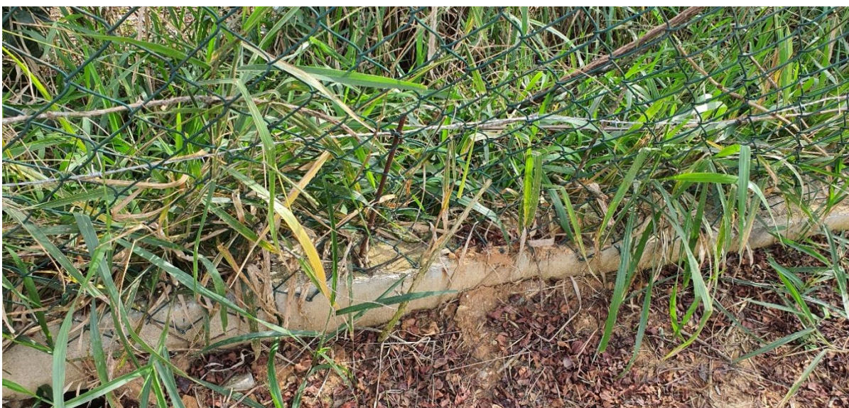
Foto 20 – Detalhes da fundação construída com blocos canaleta demonstrando que não foi construído em vala e está sobre a superfície do solo. Detalhe de mais um arranque para pilarete/espera.
