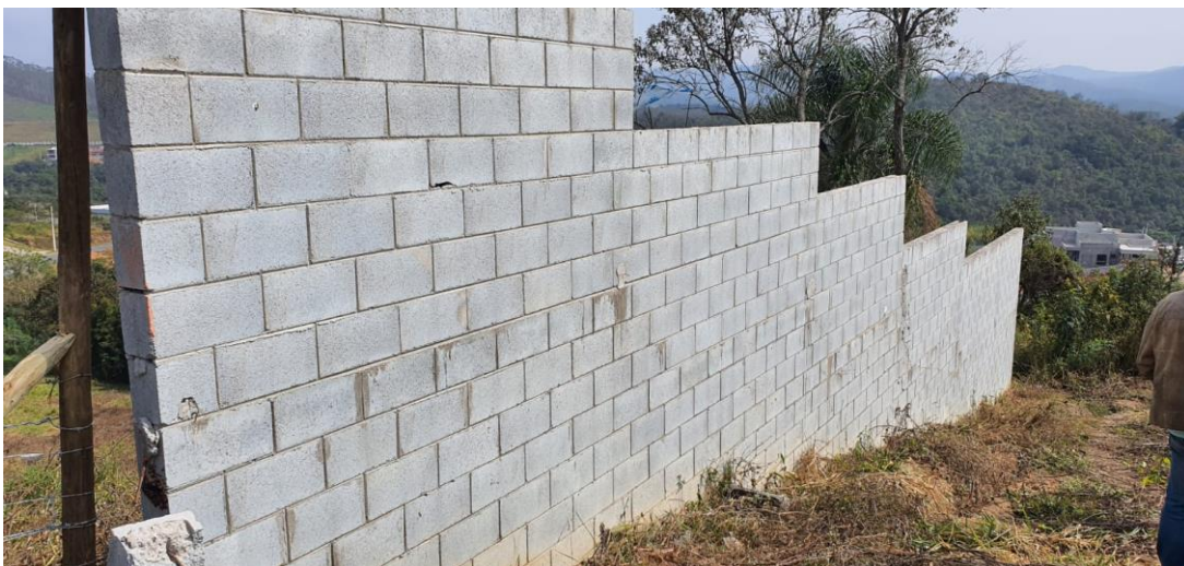
Foto 08 – Trecho ao lado do ponto colapsado que ainda permanece íntegro, verifica-se a ausência de amarrações, bem como, a ausência dos pilaretes visíveis.
