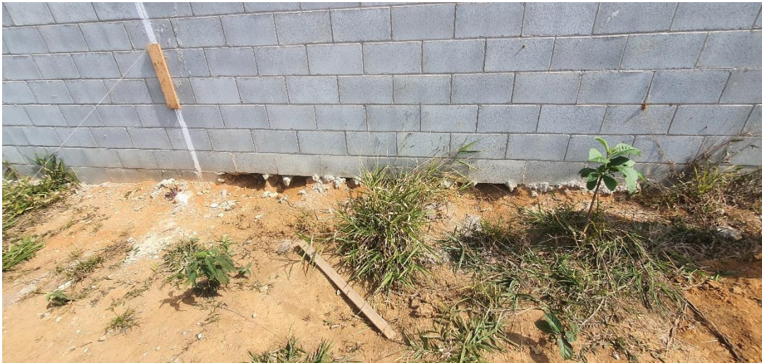
Foto Detalhe 09 – Vista frontal do muro, demonstrando o “baldrame” feito em bloco canaleta.
