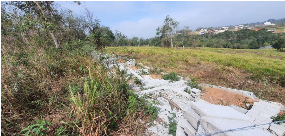
Foto 06 – Trecho colapsado também com ruptura na base do muro.
