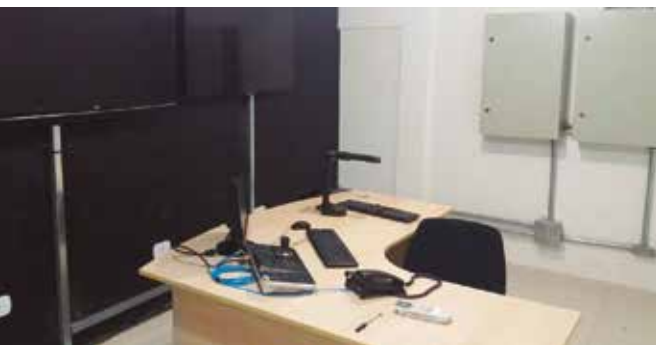
▲ Nova central de monitoramento fica próxima à portaria da reserva
