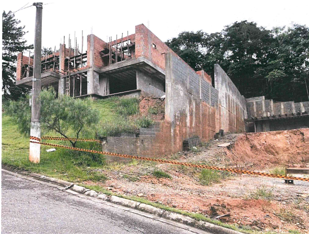
Imagem 3: Local interditado pela Defesa Civil. Necessidade com urgência por intervenção técnica e executiva.
