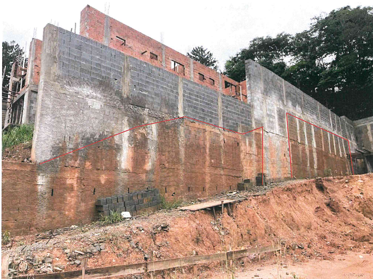
Imagem 2: Muro de arrimo de grande porte, risco iminente de desabamento. Local interditado. Linha de umidade contra barranco.
