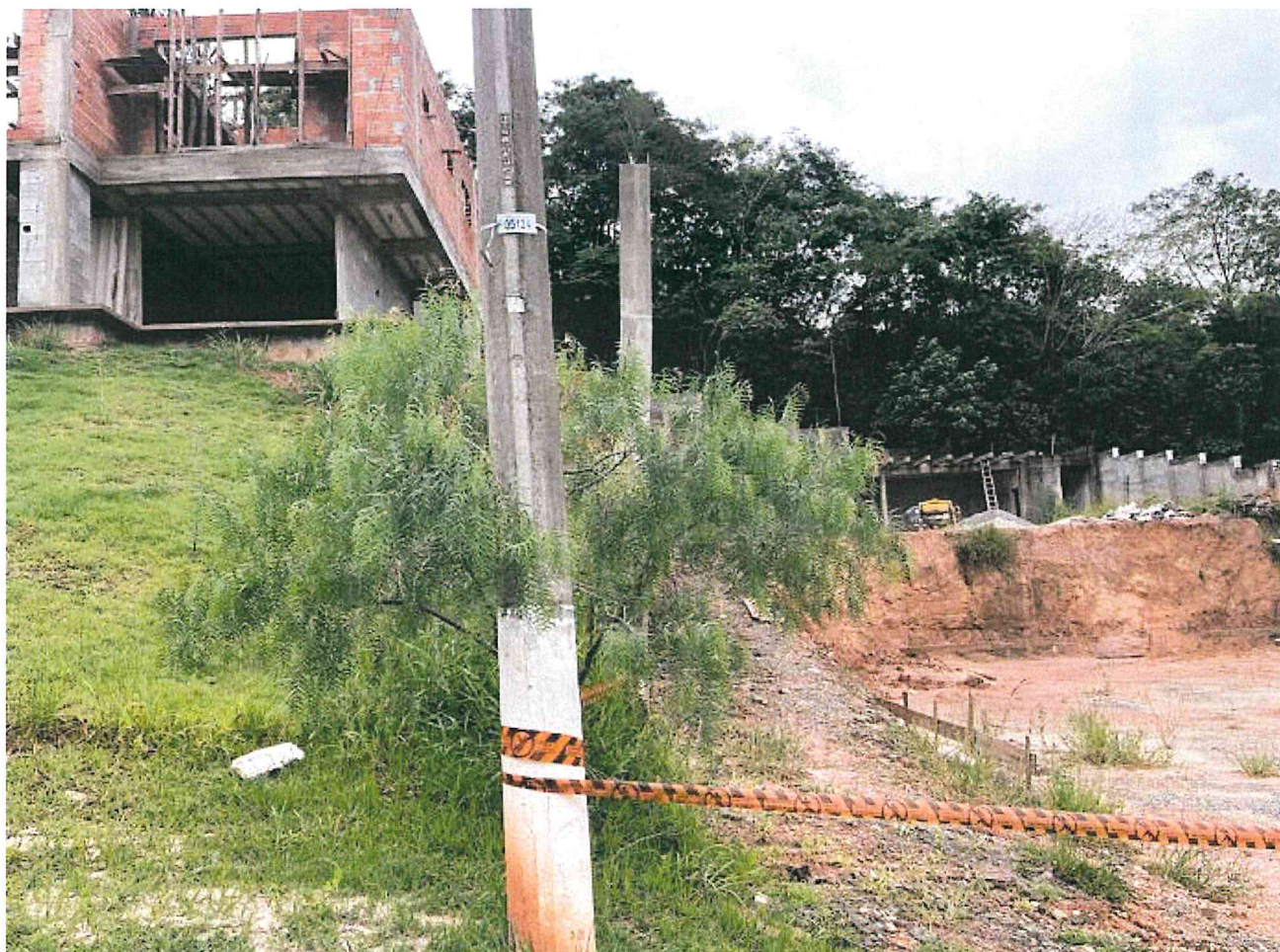
Imagem 4: Evidente inclinação em muro de divisa.
